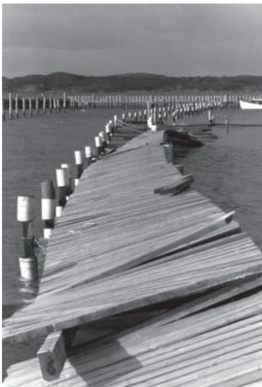
Skador av högt vattenstånd
